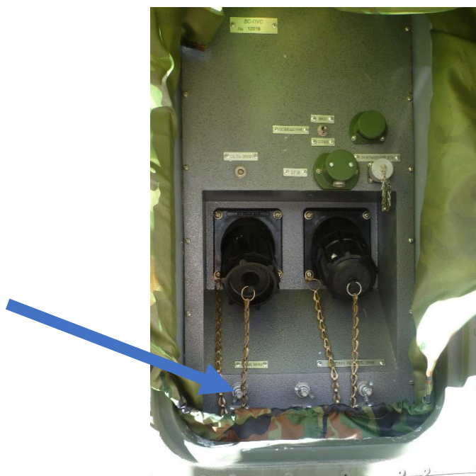
Рисунок 7.8. – Клемма для подключения наконечников заземляющих проводников силовых кабелей к ВС-ПУС
