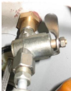
Рисунок 3.11. – Кран подачи топлива от бака к установке
